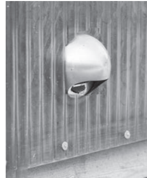
床近くの低い位置に設けたベントキャップ。上部の窓と合わせて、室内の自然換気が促される
